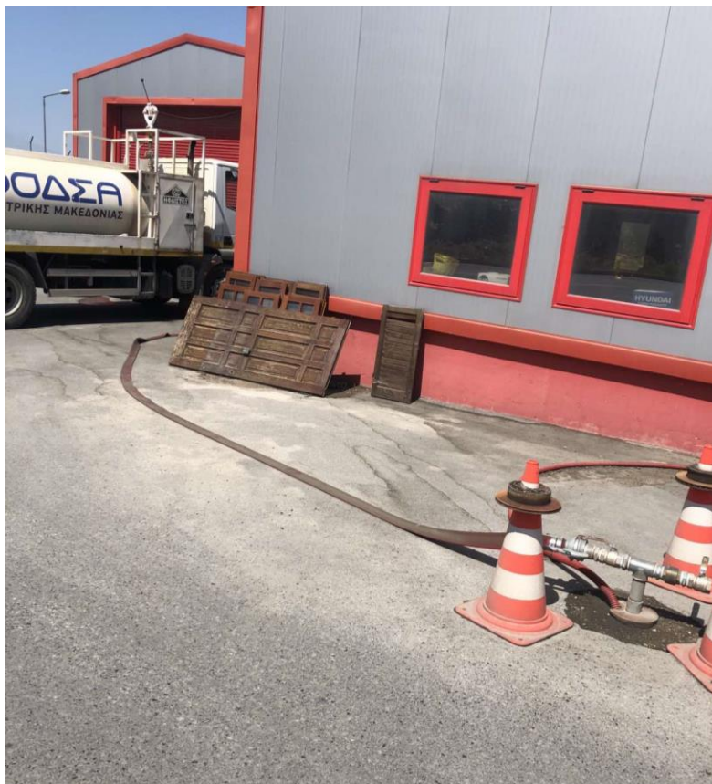
Εικόνα 2.5 Άποψη της θέσης της υφιστάμενης (προσφάτως διανοιχθείσας) γεώτρησης όπου διακρίνεται το λάστιχο που μεταφέρει το αντλούμενο νερό στην υδροφόρα.
