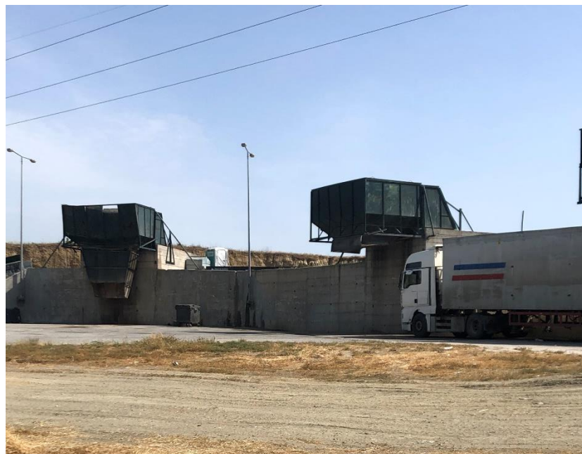
Εικόνα 2.7 Άποψη της 3ης και της 2ης (κατά σειρά) χοάνης του Σταθμού. Η πλατεία ελιγμών αποτελείται από ασφάλτο και τσιμέντο, ενώ Νοτιοδυτικά αυτής από χερσαία έκταση. Είναι εμφανείς οι φθορές της ασφάλτου και του τσιμέντου
