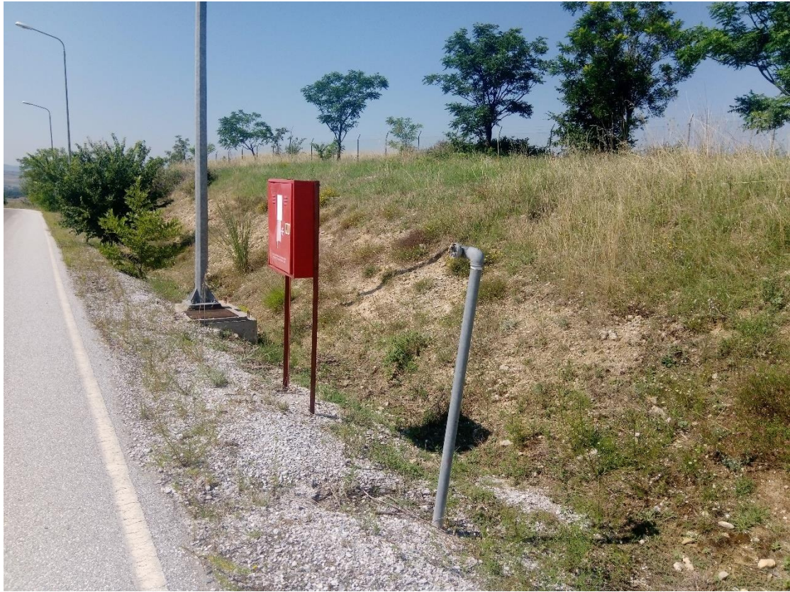
Εικόνα 2-22 Πυροσβεστική φωλιά και λήψη παρόδια της ασφαλτοστρωμένης οδού κυκλοφορίας του ΣΜΑ Ζίχνης
