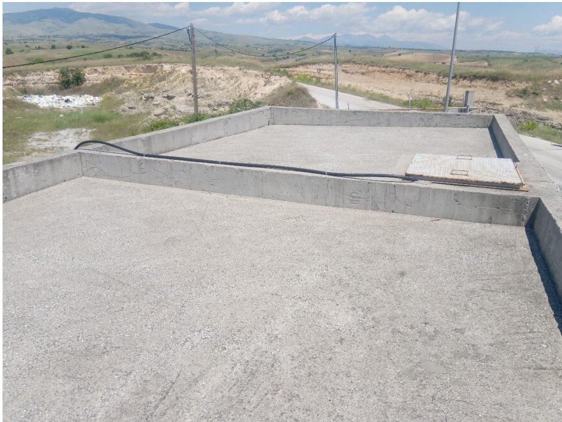
Εικόνα 2-26 Άποψη του δώματος της δεξαμενής νερού-πυρόσβεσης του ΣΜΑ Ζίχνης (υγρός θάλαμος αυτής)
