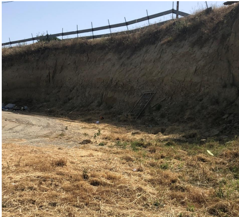
Εικόνα 2.10 Στο Νότιο πρανές του ΣΜΑ, παρουσιάζονται καταπτώσεις που έχουν ως επακόλουθο την καταστροφή του στηθαίου ασφαλείας της οδού πρόσβασης στον Σταθμό.
