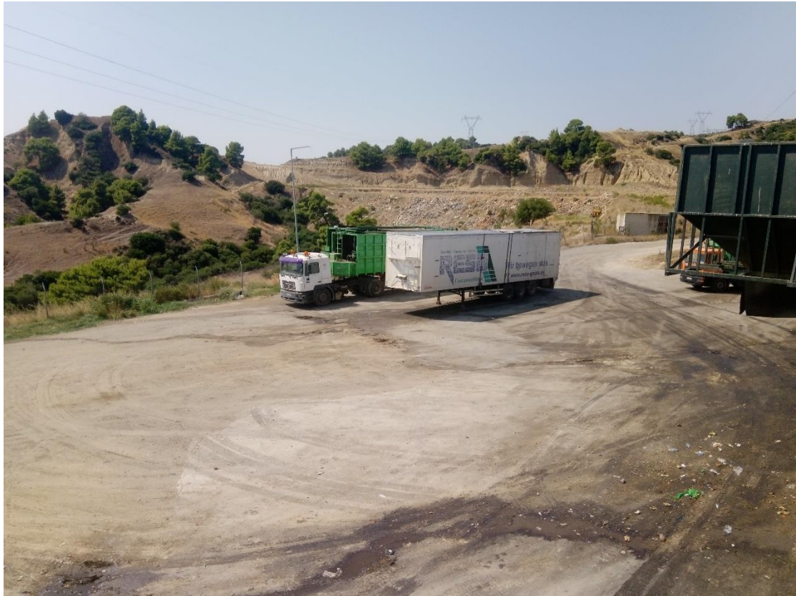
Εικόνα 2.9 Αποψη της πλατείας ελιγμών από τον χώρο των χονών. Διακρίνεται η χρήση διαφορετικών υλικών της πλατείας (άσφαλτος, τσιμέντο, χέρσο), καθώς και οι φθορές που φέρουν. Διακρίνεται η απουσία οποιασδήποτε δομής διαχείρισης των στραγγισμάτων που παράγονται κατά τη λειτουργία του ΣΜΑ
