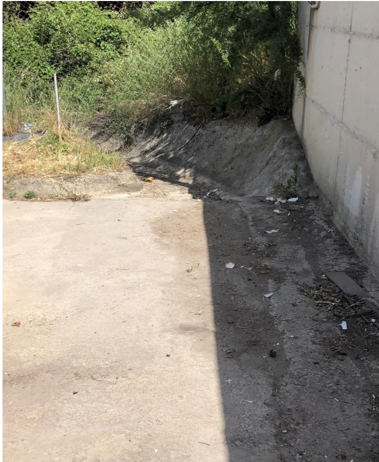
Εικόνα 2.19 Αποψη της περιοχής εκκένωσης της τάφρου αποχέτευσης ομβρίων υδάτων. Διακρίνεται τοπική φθορά των τοιχείων και του πυθμένα της.
