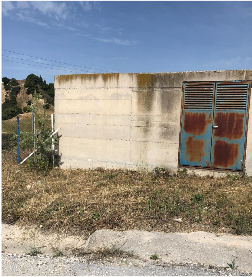
Εικόνα 2.5 Το υφιστάμενο αντλιοστάσιο πυρόσβεσης (δεξαμενή νερού). Εκτός της αδυναμίας λειτουργίας του πιεστικού συγκροτήματος του αντλιοστασίου, παρατηρούνται επιπλέον φθορές στον στατικό φορέα του (εμφάνιση υγρασίας επί του δώματος και των εξωτερικών τοιχείων αυτού)
