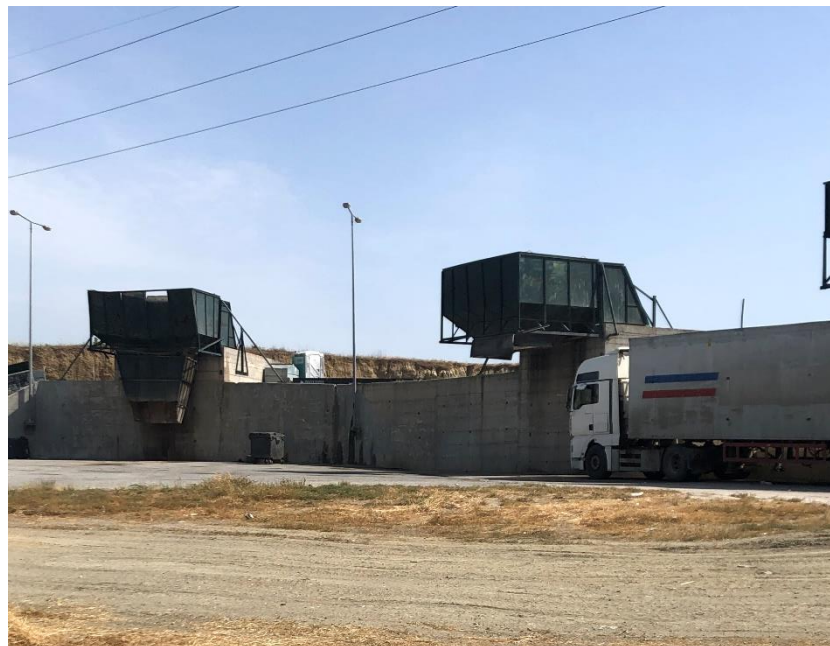
Εικόνα 2.7 Άποψη της 3ης και της 2ης (κατά σειρά) χοάνης του Σταθμού. Η πλατεία ελιγμών αποτελείται από άσφαλτο και τσιμέντο, ενώ Νοτιοδυτικά αυτής από χερσαία έκταση. Είναι εμφανείς οι φθορές της ασφάλτου και του τσιμέντου
