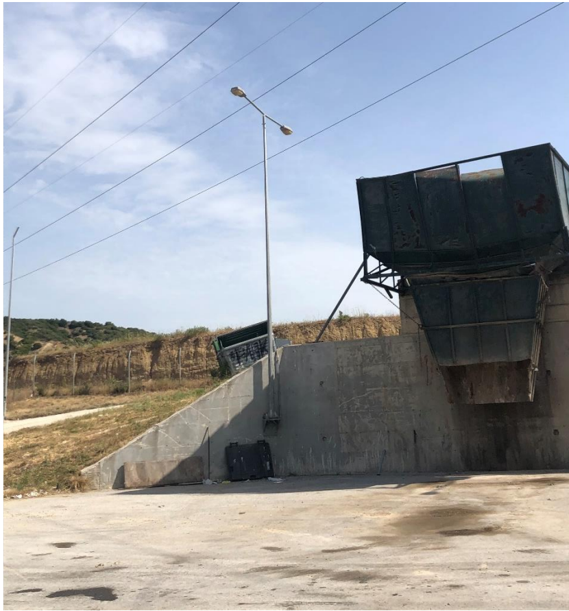
Εικόνα 2.6 Άποψη της περιοχής της 3ης (κατά σειρά) χοάνης του ΣΜΑ. Διακρίνονται επιφανειακές φθορές της πλατείας ελιγμών του Σταθμού
