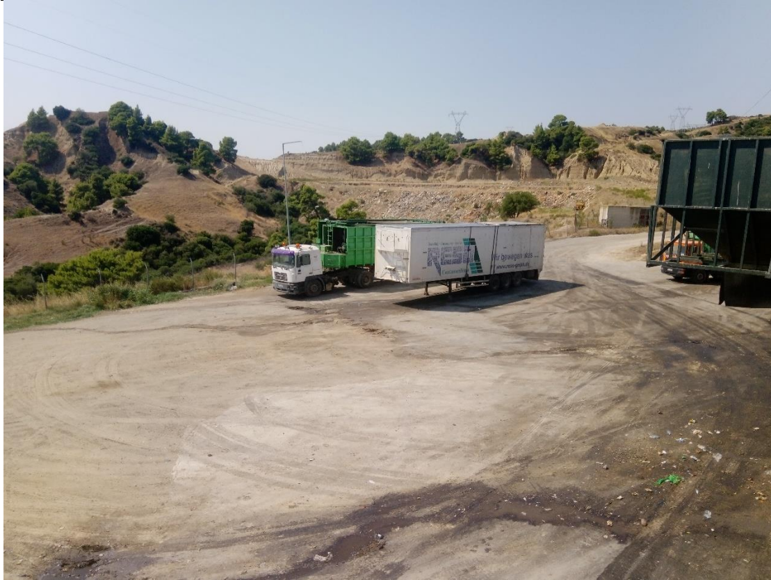
Εικόνα 2.9 Αποψη της πλατείας ελιγμών από τον χώρο των χοανών. Διακρίνεται η χρήση διαφορετικών υλικών της πλατείας (άσφαλτος,τσιμέντο, χέρσο), καθώς και οι φθορές που φέρουν. Διακρίνεται η απουσία οποιασδήποτε δομής διαχείρισης των στραγγισμάτων που παράγονται κατά τη λειτουργία του ΣΜΑ
