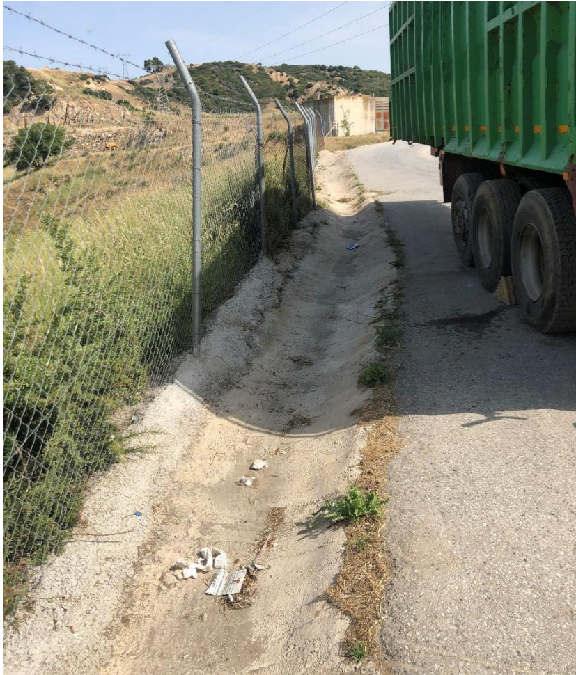
Εικόνα 2.8 Η υφιστάμενη τάφρος αποχέτευσης ομβρίων υδάτων που διατρέχει τον ΣΜΑ στο Βόρειο και στο Δυτικό τμήμα περιμετρικά αυτού.
