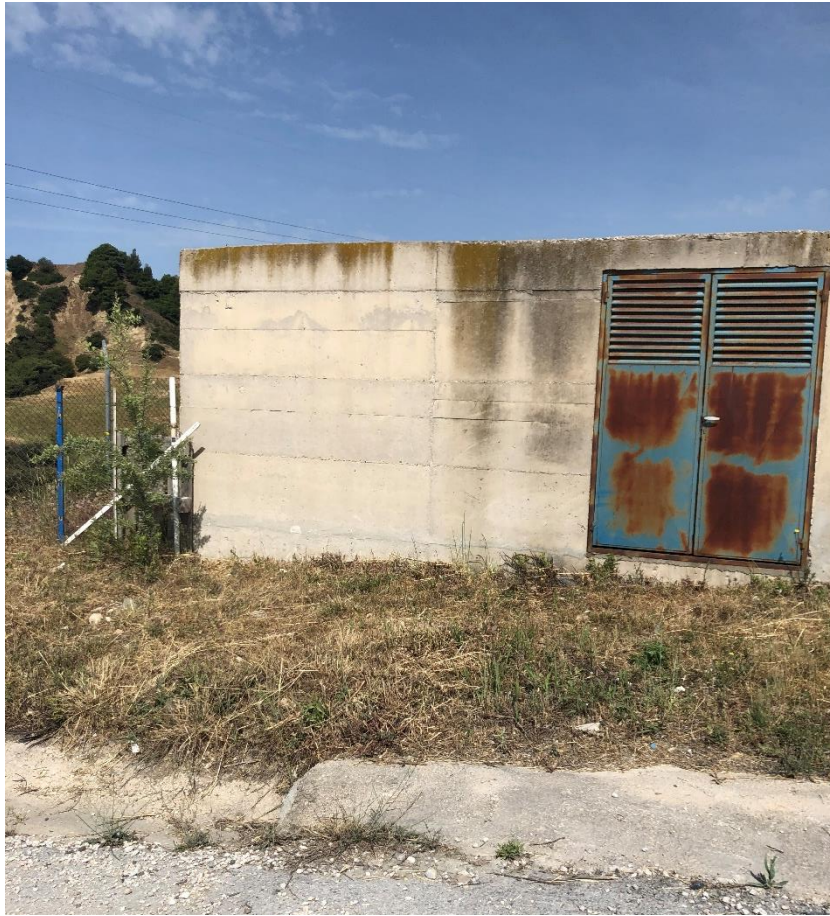
Εικόνα 2.5 Το υφιστάμενο αντλιοστάσιο πυρόσβεσης (δεξαμενή νερού). Εκτός της αδυναμίας λειτουργίας του πιεστικού συγκροτήματος του αντλιοστασίου, παρατηρούνται επιπλέον φθορές στον στατικό φορέα του (εμφάνιση υγρασίας επί του δώματος και των εξωτερικών τοιχείων αυτού)
