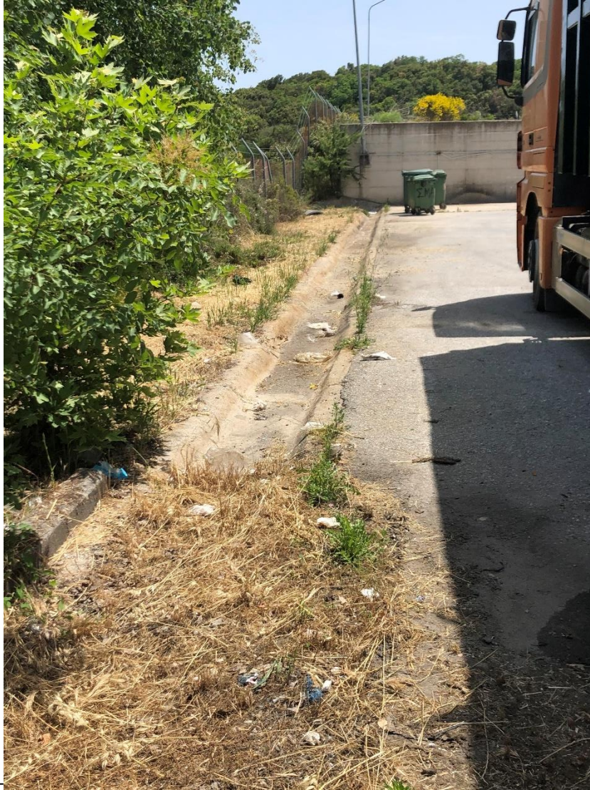
Εικόνα 2.7 Αποψη της τάφρου απορροής ομβρίων υδάτων στην Βόρεια πλευρά του ΣΜΑ. Η παρουσία πολλών φερτών παρεμποδίζει την ομαλή λειτουργία της.
