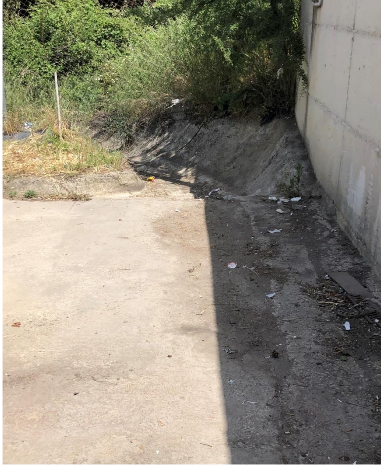
Εικόνα 2.8 Άποψη της περιοχής εκκένωσης της τάφρου αποχέτευσης ομβρίων υδάτων. Διακρίνεται τοπική φθορά των τοιχείων και του πυθμένα της.
