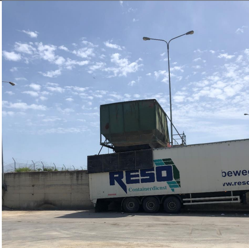
Εικόνα 2.9 Άποψη της περιοχής της πλατείας ελιγμών του ΣΜΑ Ιερισσού. Όπισθεν του οχήματος διακρίνεται το τοιχείο αντιστήριξης του δεύτερου (ψηλότερου) επιπέδου του ΣΜΑ, στο οποίο παρουσιάζονται ίχνη υγρασίας τόσο στη στέψη όσο και στη βάση του.
