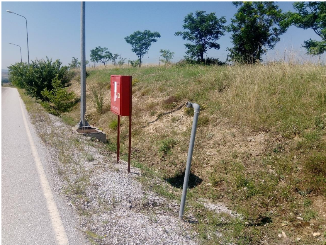
Εικόνα 2-2 Πυροσβεστική φωλιά και λήψη παρόδια της ασφαλτοστρωμένης οδού κυκλοφορίας του ΣΜΑ Ζίχνης
