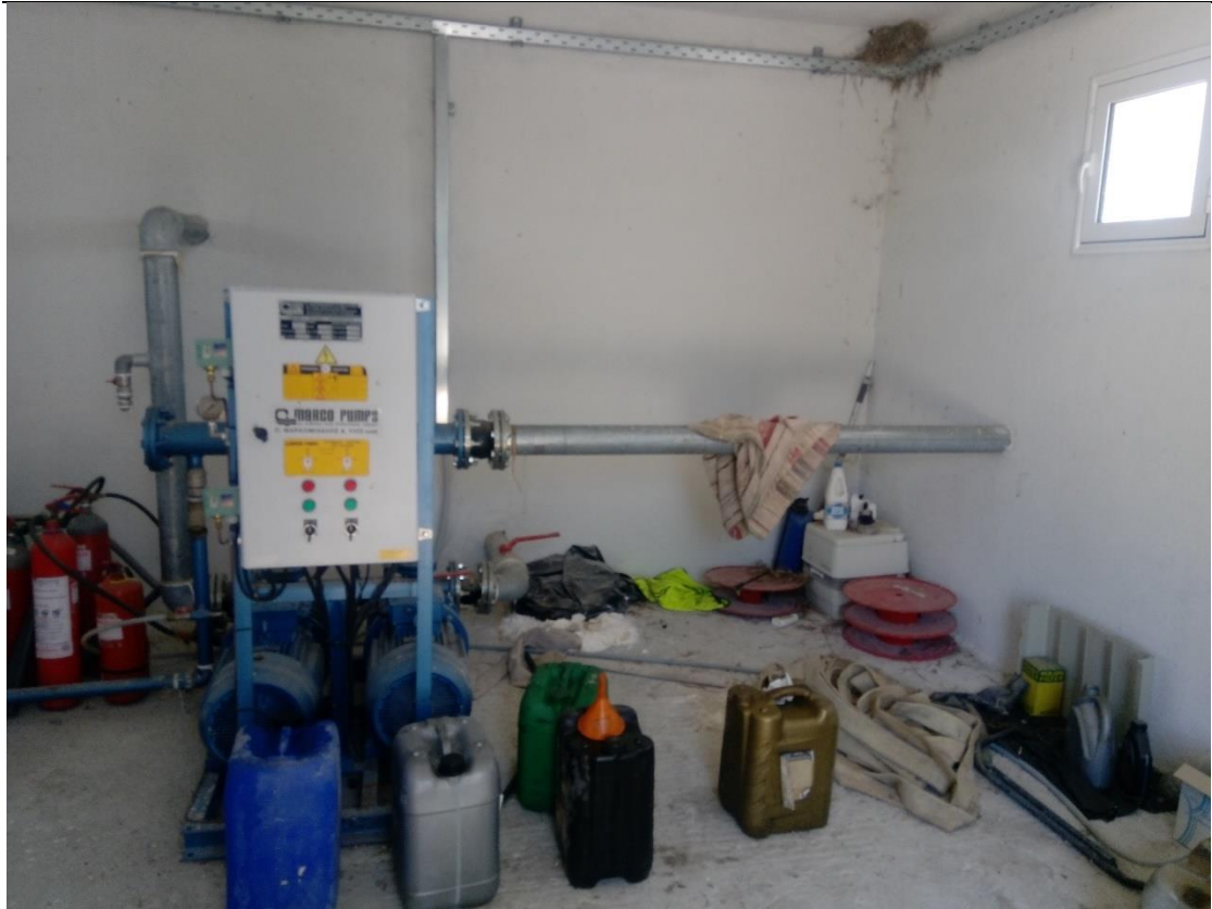
Εικόνα 2-5 Άποψη του εσωτερικού του αντλιοστασίου (ξηρός θάλαμος)
