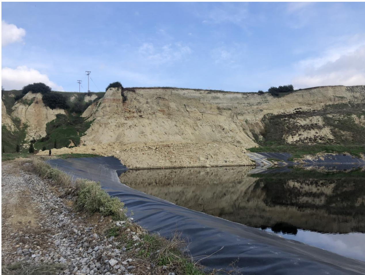
Εικόνα 1 Άποψη του Βόρειου πρανούς της Βορειοανατολικής λιμνοδεξαμενής αποθήκευσης στραγγισμάτων του αποκατεστημένου ΧΑΔΑ Ταγαράδων που έχει αστοχήσει. Διακρίνεται η πτώση χωματισμών εντός της ανωτέρω λιμνοδεξαμενής και η δημιουργία προσωρινής χωμάτινης οδού μεταξύ του κατολισθήσαντος πρανούς και του φρυδιού των πρανών της λιμνοδεξαμενής.
