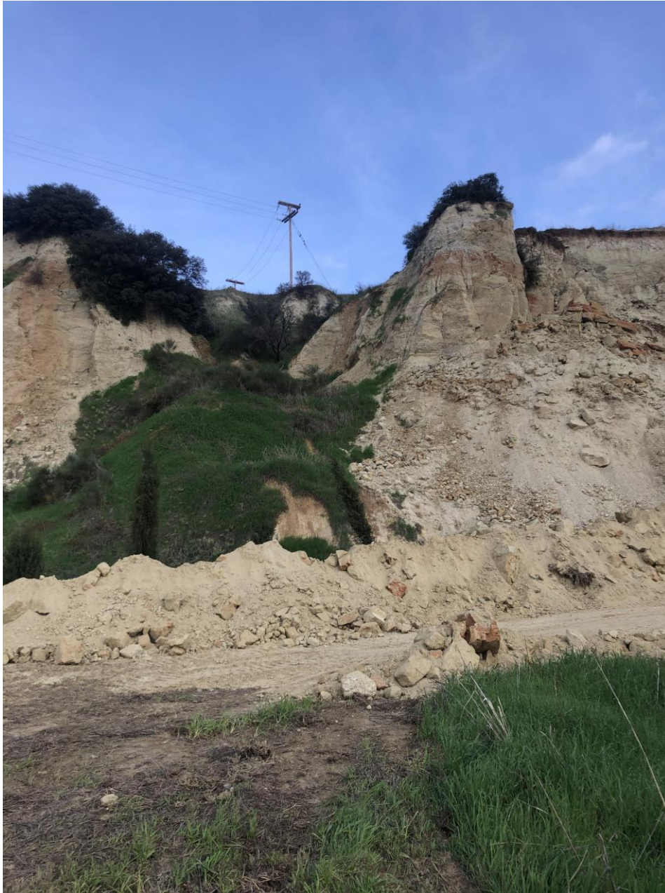
Εικόνα 2 Κοντινότερη άποψη του Βόρειου πρανού της Βορειοανατολικής λιμνοδεξαμενής αποθήκευσης στραγγισμάτων του αποκατεστημένου ΧΑΔΑ Ταγαράδων που έχει αστοχήσει. Διακρίνονται κατακόρυφα τμήματα επί του πρανού που έχουν αποκολληθεί και είναι πιθανό να αστοχήσουν το επόμενο διάστημα.
