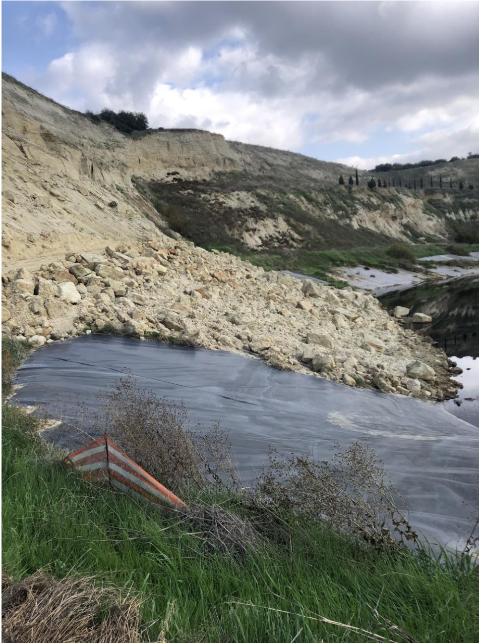
Εικόνα 3 Άποψη των χωματισμών του υφιστάμενου πρανούς που υπερκάλυψαν τμήμα της γεωμεμβράνης των πρανών της λιμνοδεξαμενής.
