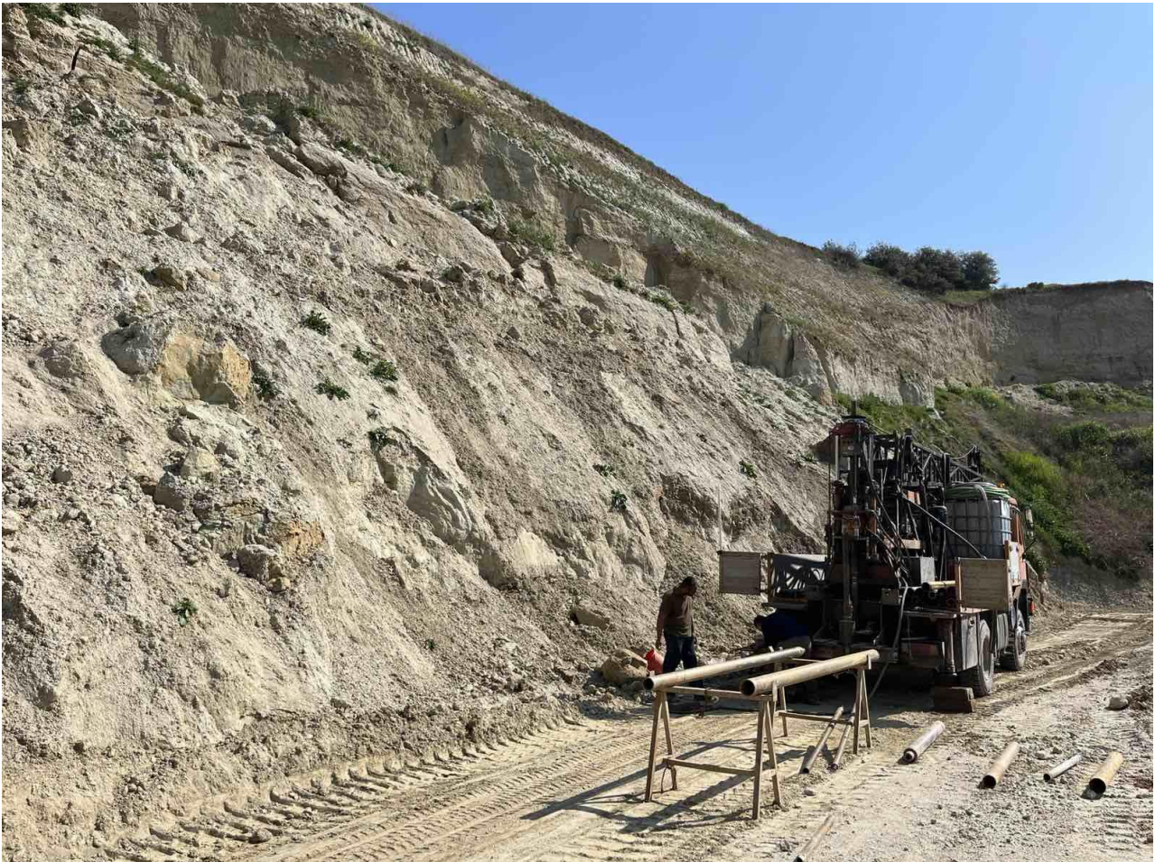
Εικόνα 7 Θέση υλοποίησης της δειγματοληπτικής γεώτρησης Γ1 βάθους 20,0m. Διακρίνεται ο εξοπλισμός και το γεωτρήπανο με κατεύθυνση προς τα Ανατολικά.
