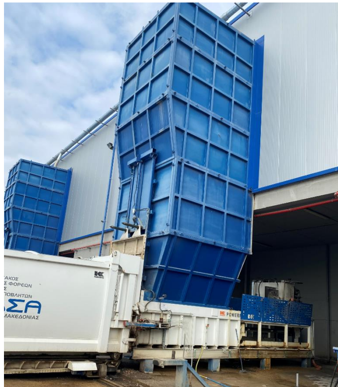
Εικόνα 1. Χοάνη μεταφόρτωσης και πρέσσα συμπίεσης απορριμμάτων
