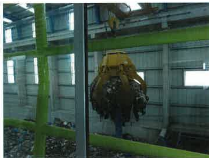
Εικόνα 6-2: Άποψη αρπάγης απορριμμάτων αναρτημένης σε φορείο γερανογέφυρας
