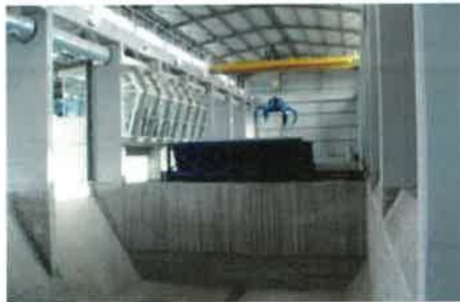
Εικόνα 6-1: Άποψη χώρου υποδοχής με τάφρο και γερανογέφυρα μεταφοράς των απορριμμάτων
